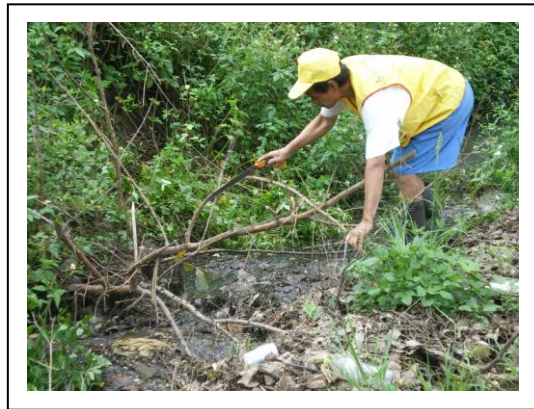
環境維護前實景 (水溝不通、樹木雜草影響排水) 使用鋸子鋸斷樹枝
